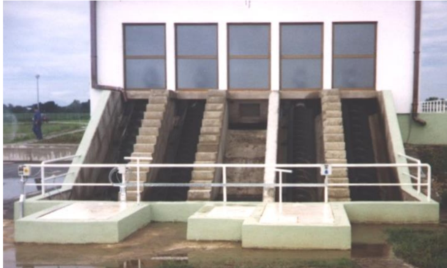
Slika 10. Crpilište biljnog mulja
