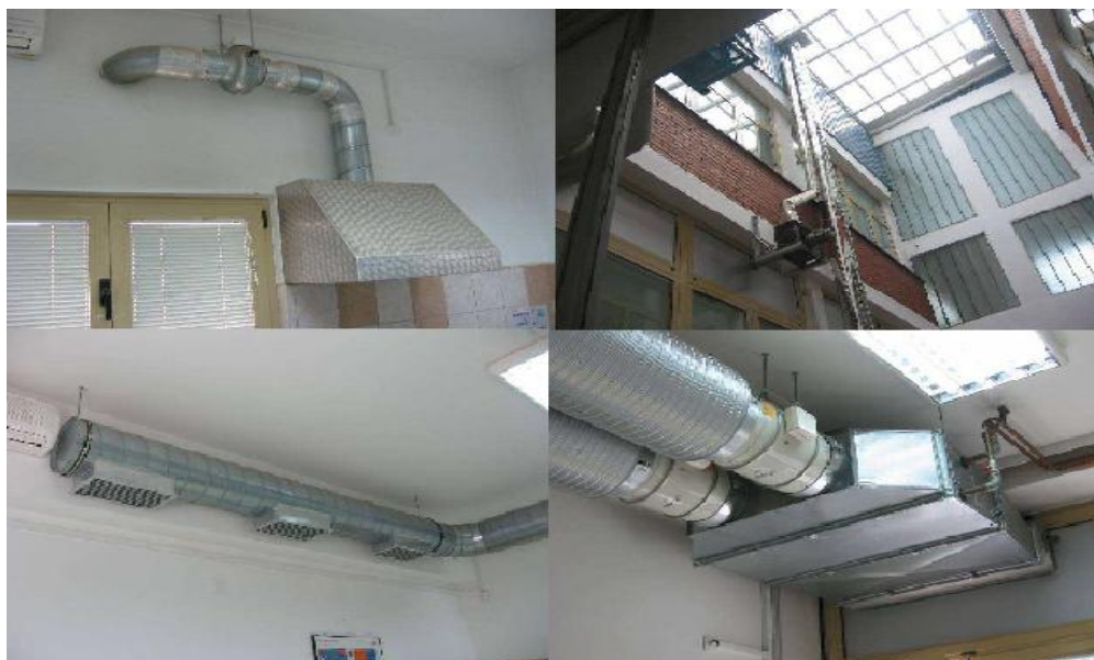
Slika 8. Odsisnapa (lijevo, gore), kanali za odvod otpadnog zraka (gore, desno), kanalni razvod svježeg zraka (dolje, lijevo) i toplovodnizagrijač (dolje, desno) u laboratoriju u zgradi Geotehničkog fakulteta u Varaždinu [6]
