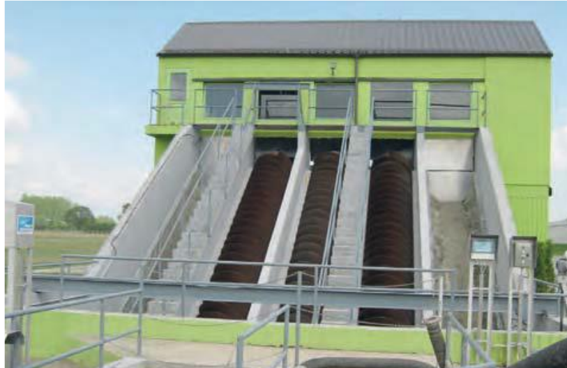
Slika 4. Stari uređaj za pročišćavanje [12]
