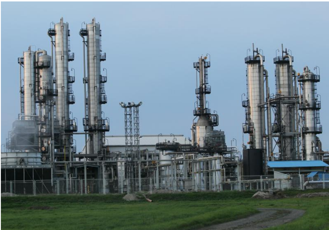
Slika 5 INA-ino postrojenje za vađenje plina Centralna plinska stanica Molve [11]
