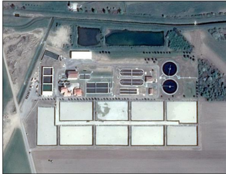
Slika 2. Uređaj za pročišćavanje otpadnih voda Čakovec [5]
