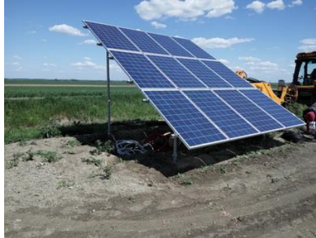
Slika 20. Fotonaponski moduli korišteni u projektu [18]
