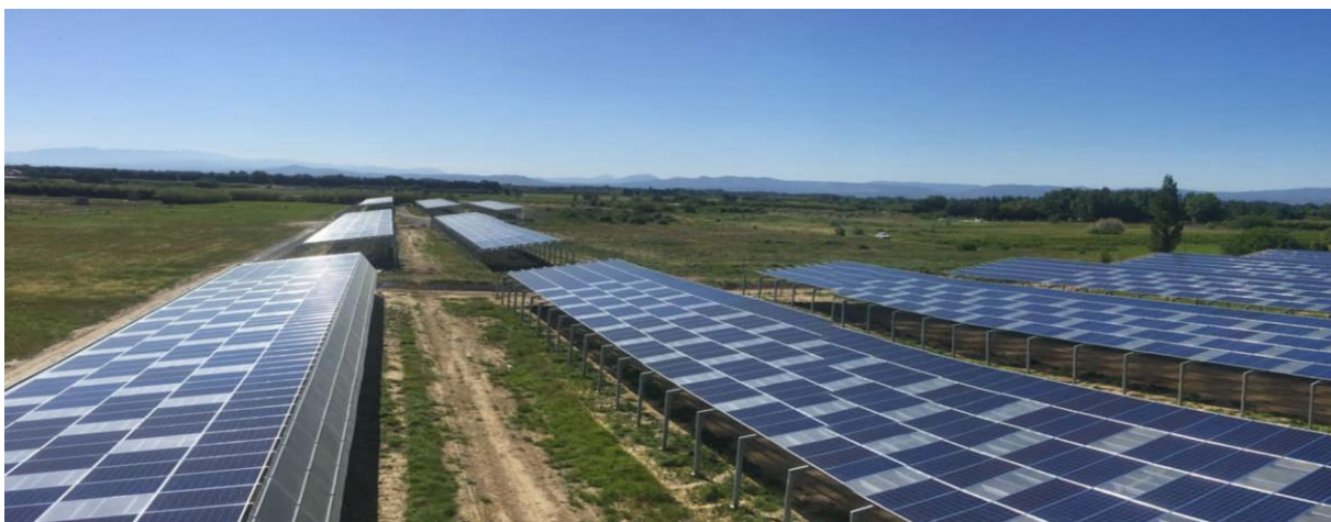
Slika 13. Torreilles solar park [27]
