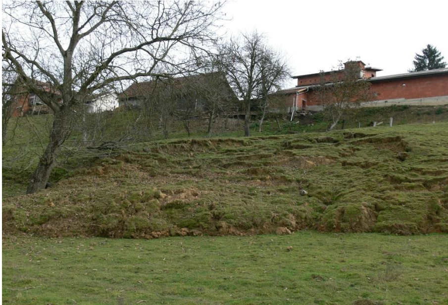
Slika 5.3. Prikaz dijela klizišta u Samarici (čeoni dio zahvatio cestu)
