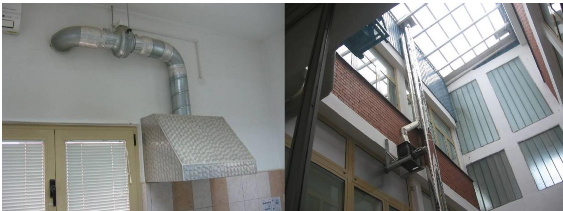
Slika 18 Odsisna napa (lijevo), cijevi za odvod otpadnog zraka (desno) [15]
