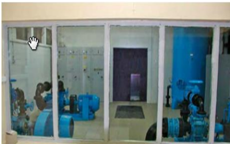
Slika 18. Crpna stanica Filipić [11]
