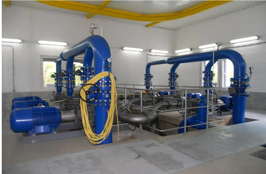
Slika 3. Primjer crpne stanice [7]
