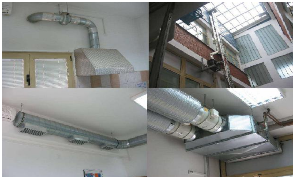
Slika 8. Odsisnapa (lijevo, gore), kanali za odvod otpadnog zraka (gore, desno), kanalni razvod svježeg zraka (dolje, lijevo) i toplovodnizagrijač (dolje, desno) u laboratoriju u zgradi Geotehničkog fakulteta u Varaždinu [6]
