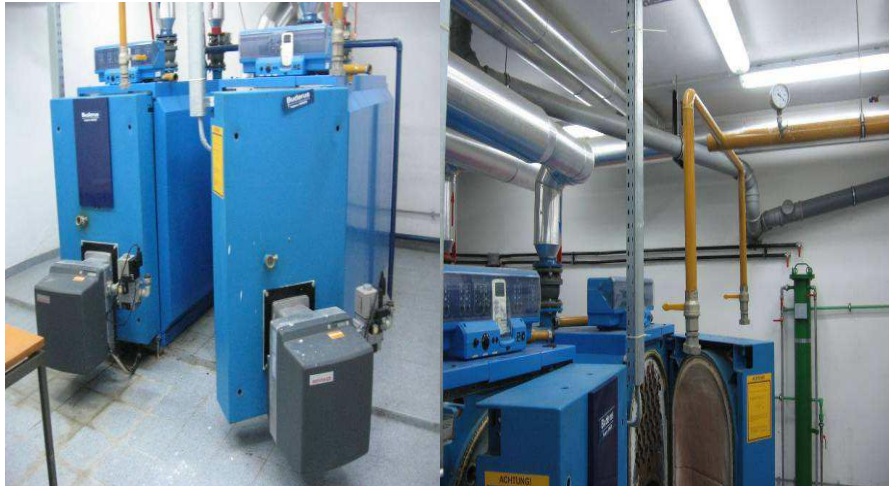
Slika 7 Toplovodni kotlovi (lijevo), dovod plina i kotlovska automatika (desno) u kotlovnici zgrade Geotehničkog fakulteta u Varaždinu [6]
