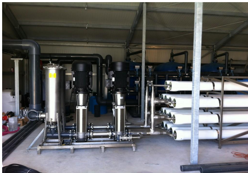
Slika 5. Postrojenje za desalinaciju bočate vode [5]
