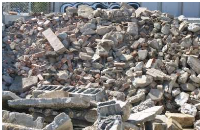
Slika 1. Šuta nastala tijekom rušenja [3]
