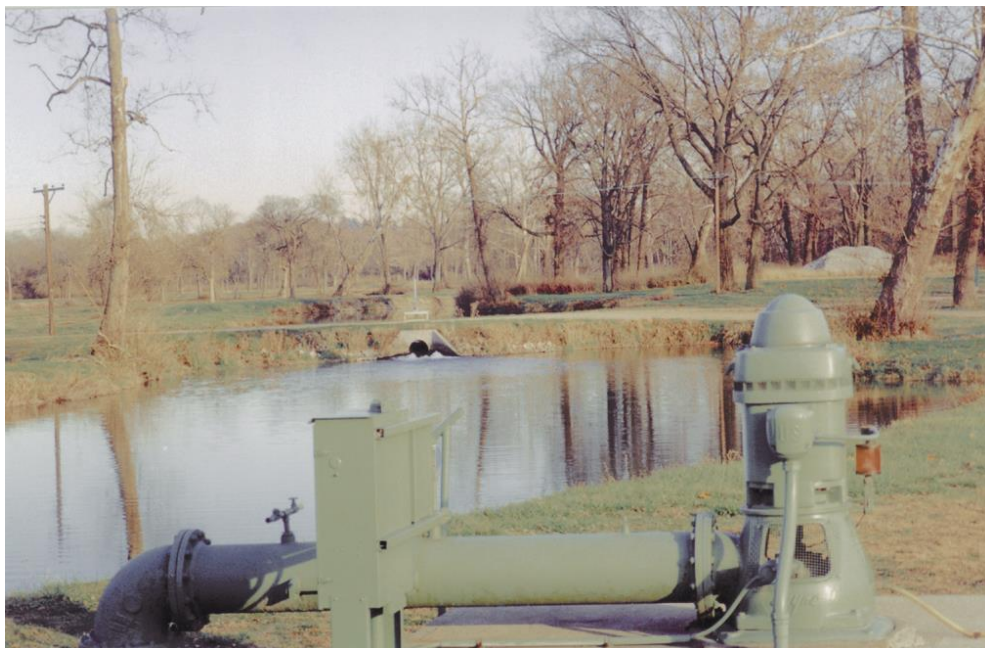
Slika 11. Turbinska pumpa velike snage instalirana na gradskoj bušotini na otoku Rohrsers. (laguna prihranjivanja u pozadini) (Alley, M. et al., 1999)
