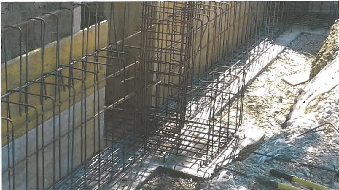
Slika 4. Prikaz temeljne konstrukcije.
