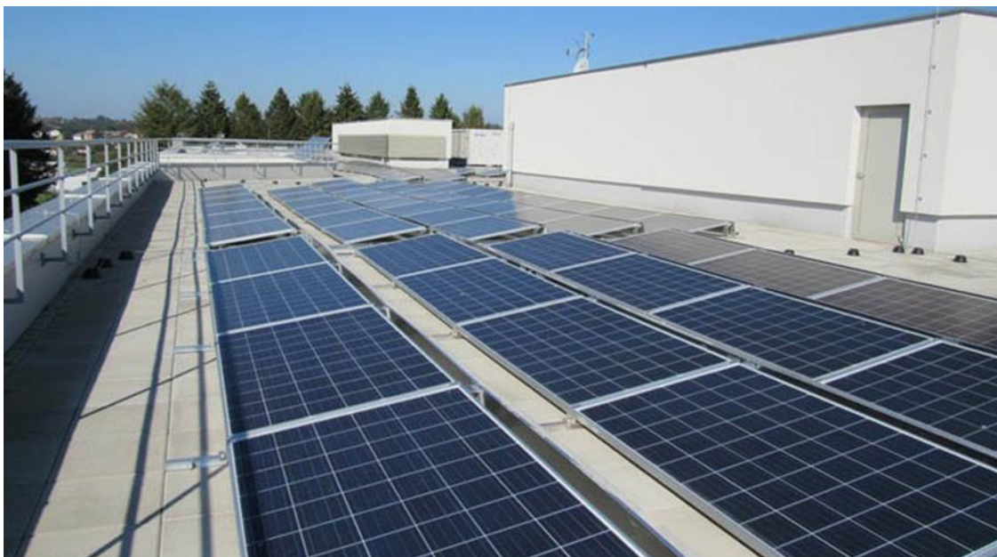
Slika 1. Sunčana elektrana Razvojnog i tehnološkog parka Križevci (Energetika, 2018.)
