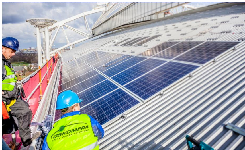
Slika 17. Solarni paneli na Amsterdam Areni [37]
