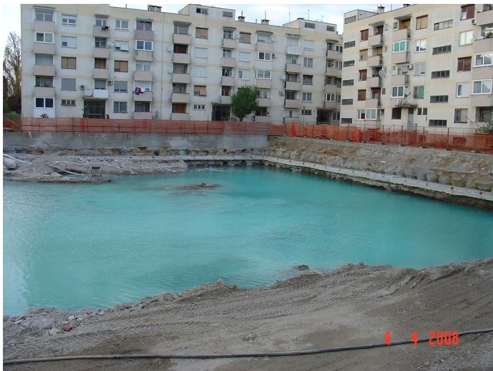
Slika 20. Podzemna voda u građevinskoj jami
