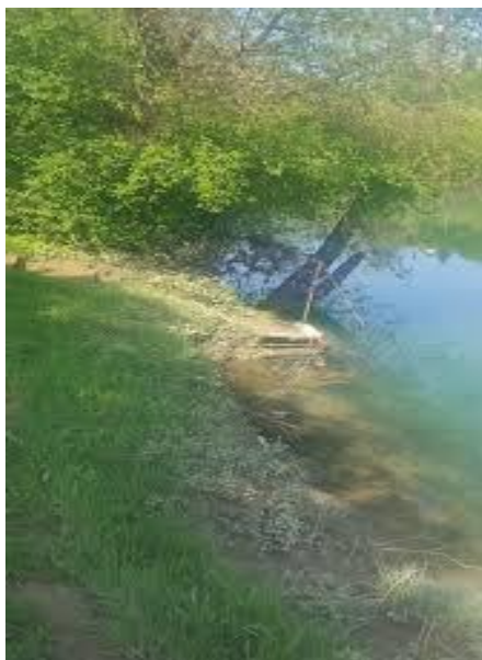
Slika 26. Prikaz postojećeg stanja prije sanacije
