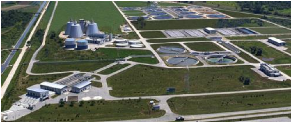
Slika 8 Centralni uređaj za pročišćavanje otpadnih voda grada Zagreba [28]
