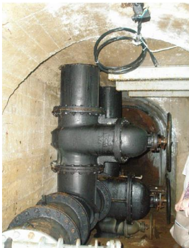
Slika 9. Ubodna cijev u hidrotehničkom tunelu [20]
