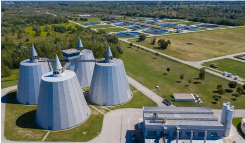
Slika 9. Digestori bioplinskog postrojenja u Zagrebu [17]
