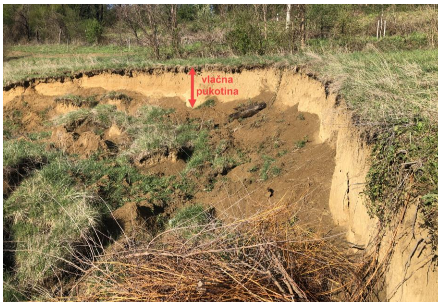
Slika 5.4. Klizište Petrovsko s prikazom vlačne pukotine
