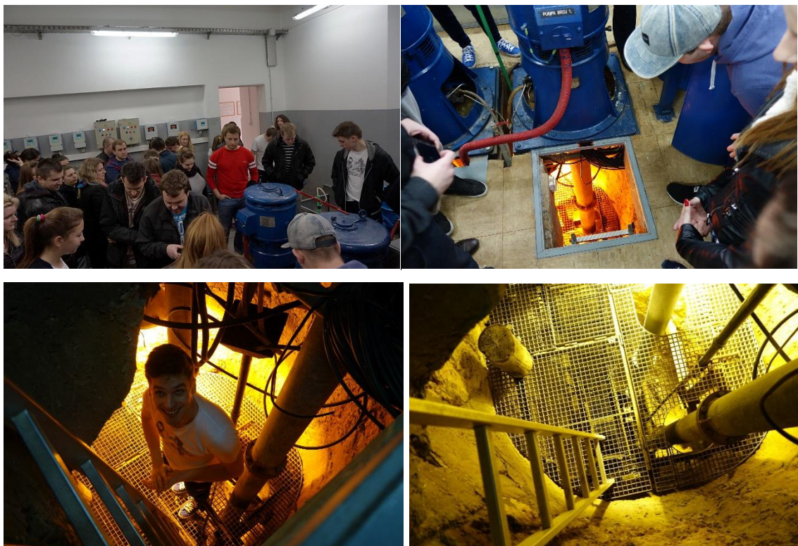
Slika 5. Kontrolna soba (gore) s pogledom na unutrašnjost zdenca Jadreški (dolje).
