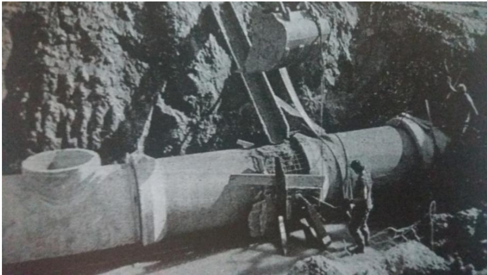
Slika 19. Sjeverni gradski kolektor [2]
