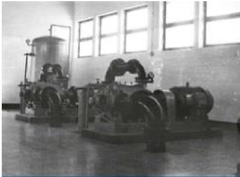
Slika 17. Prva crpna stanica na vodocrpilištu Bartolovec [11]
