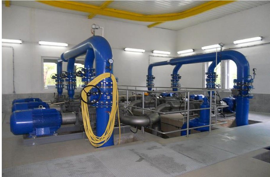
Slika 3. Primjer crpne stanice [7]
