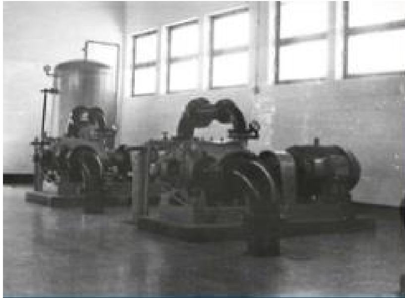
Slika 17. Prva crpna stanica na vodocrpilištu Bartolovec [11]
