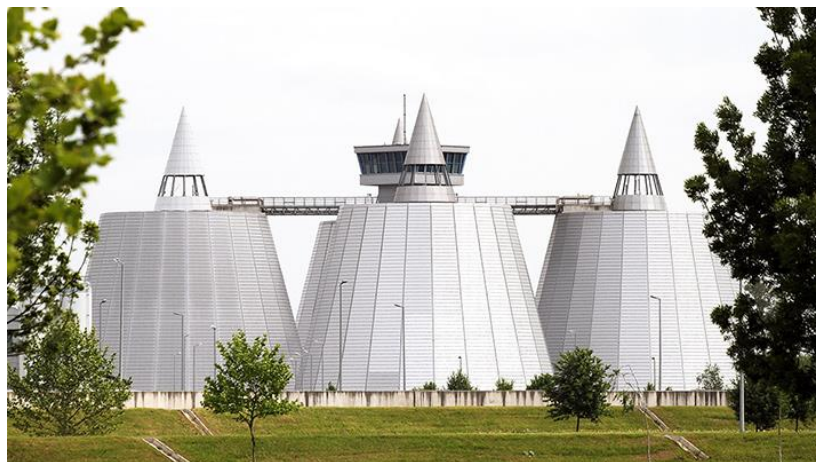
Slika 10. Tornjevi anaerobne obrade mulja na uređaju za pročišćavanje u Zagrebu [14]
