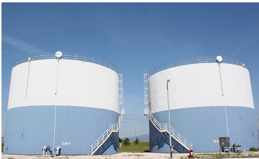
Slika 13. Spremnici za bioplin u postrojenju za obradu otpadnih voda grada Zagreba [14]
