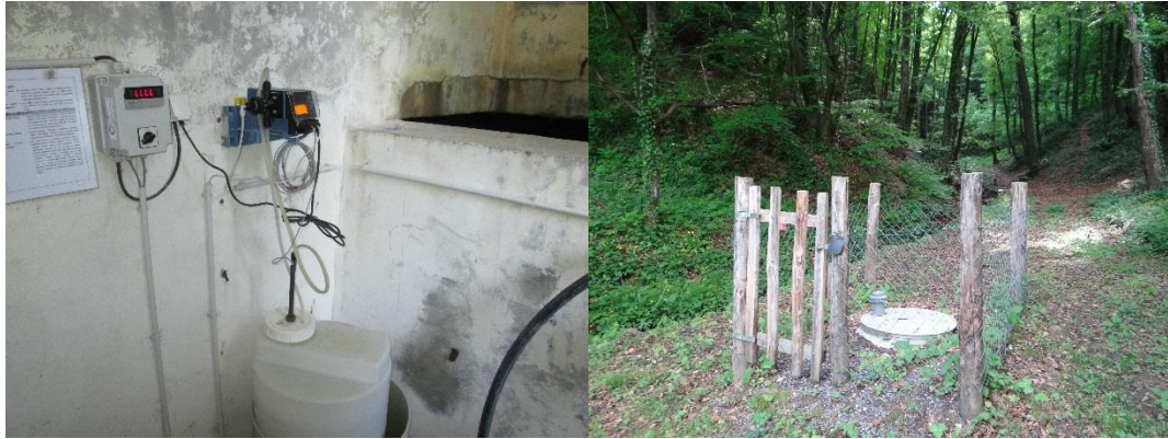
Slika 4.16. Automatski klorinator postavljen u vodospremi (Planina Donja), i postavljen direktno na vodovodnoj cijevi koja ide od izvora (Planina Gornja)
