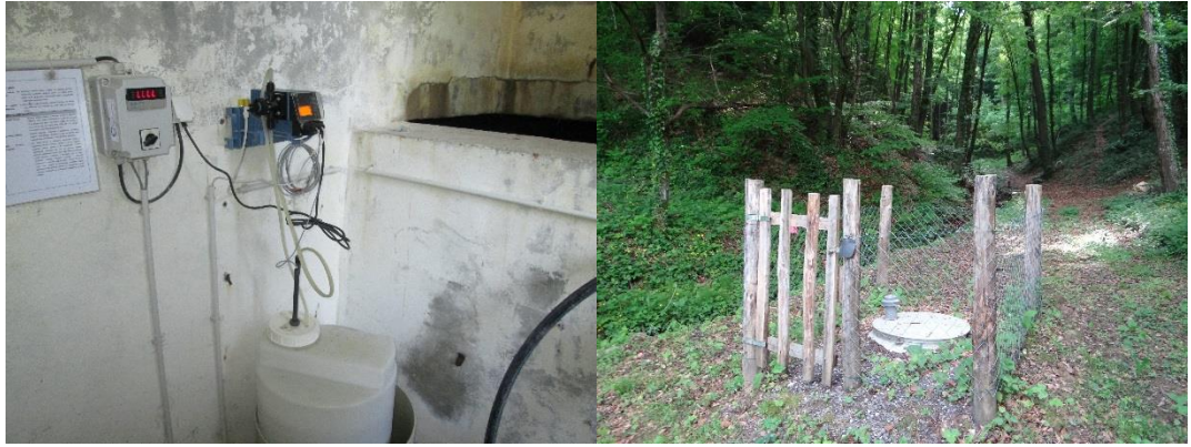
Slika 4.16. Automatski klorinator postavljen u vodospremi (Planina Donja), i postavljen direktno na vodovodnoj cijevi koja ide od izvora (Planina Gornja)
