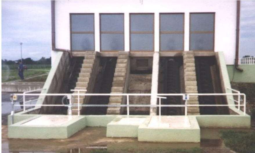
Slika 10. Crpilište biljnog mulja
