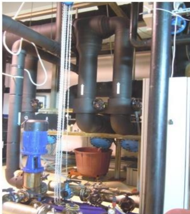
Slika 8. Sustav podizanja tlaka u pogonu [8]
