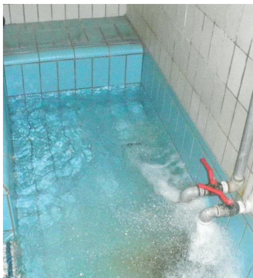
Slika 4.2. Aktualna „sumporna kupelj“ u hotelu Minerva, sumporna termo-mineralna voda
