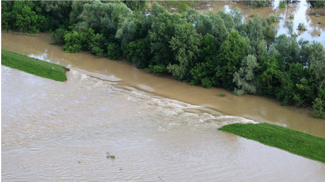
Slika 25. Propuštanje nasipa u Rajevom Selu, 2014.
