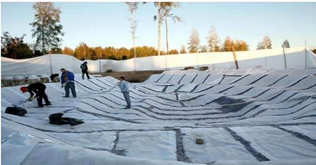
Slika 9. Geotekstil kao dio drenažnog sustava u odlagalištu otpada [9]
