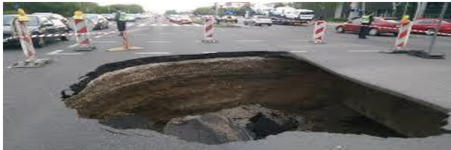
Slika 10. Propadanje prometnice u Zagrebu ( http://hr.n1info.com/a116097/Vijesti/Bandic-o-rupama-na-cesti-Zagreb-nece-propasti.html ) Datum pristupa: 24.5.2018.
