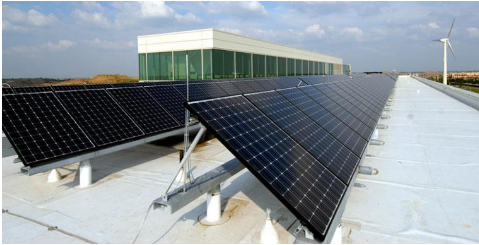
Slika 21. Prikaz bijelog krova (smanjenje učinka gradskog toplinskog otoka), fotonaponskog zida i vjetroturbine (smanjenje ovisnosti o lokalnoj električnoj mreži) [40]
