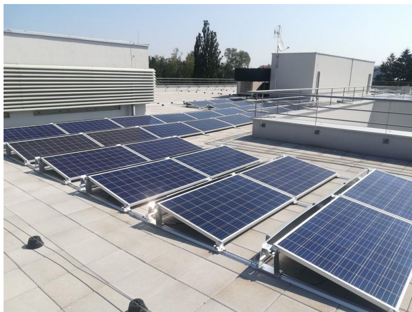
Slika 17. Solarna elektrana na zgradi Razvojnog centra i tehnološkog parka Križevci (izvor: fotografirano na lokaciji)
