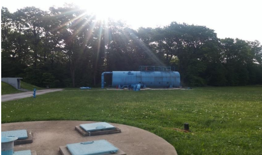
Slika 8. Sabirna komora spojena na filter s aktivnim ugljenom
