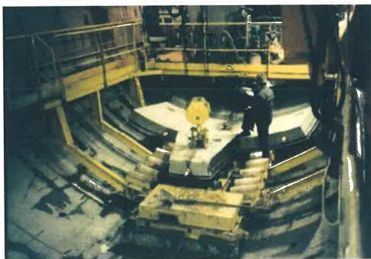
Slika 8.5. Postavljanje stroja u početno okno na gradilištu u Milanu; prikaz stražnjeg dijela stroja s podizačem kojim se segmenti postavljaju u prstenove segmentne obloge[21].
