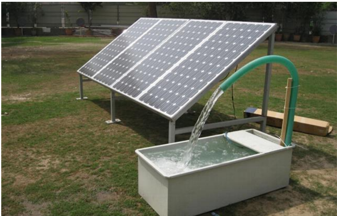
Slika 11. Mobilna solarna elektrana za navodnjavanje (građevinarstvo.rs, 2015)
