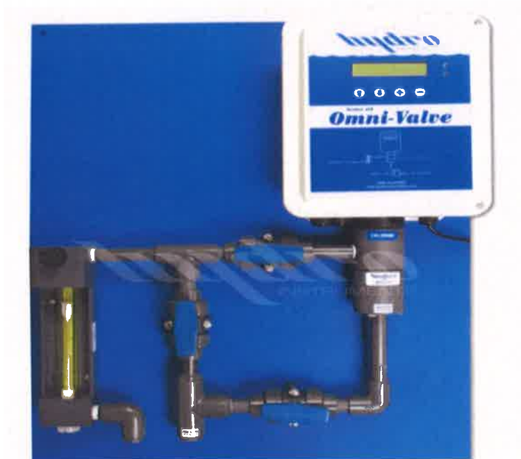
Slika 23. Primjer automatiziranog sustava kloriranja podzemne vode
