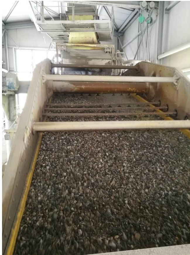
Slika br. 8. Primarno vibracijsko sito [10]
