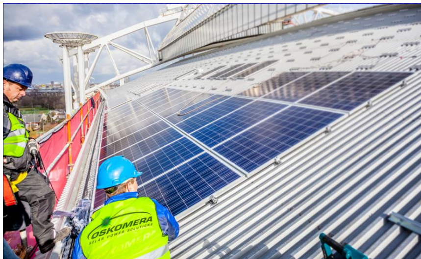
Slika 17. Solarni paneli na Amsterdam Areni [37]
