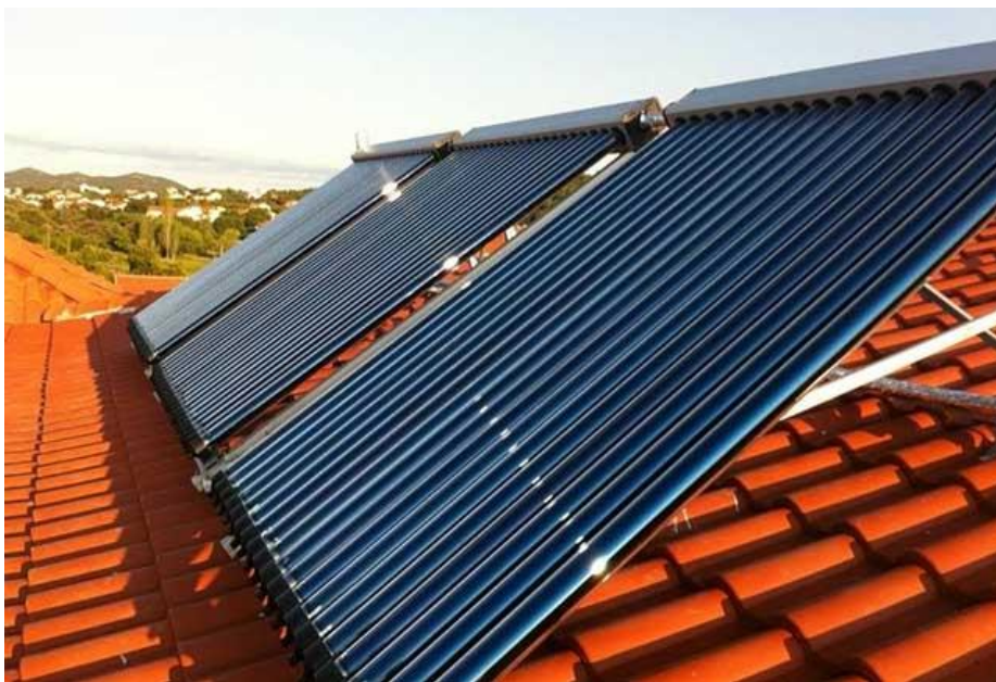
Slika 3. Sunčani toplinski kolektori [8]
