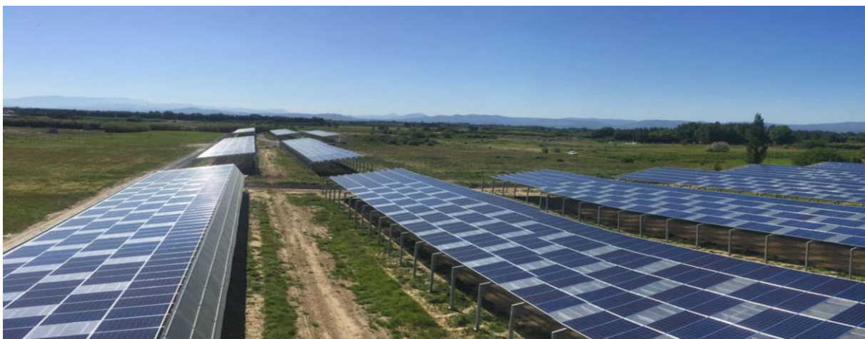
Slika 13. Torreilles solar park [27]
