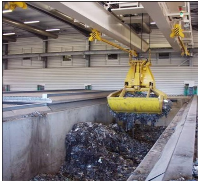
Slika 6. Utovar komore za biosušenje procesnim kranom [9]
