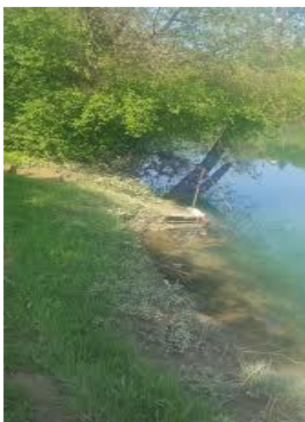
Slika 26. Prikaz postojećeg stanja prije sanacije
