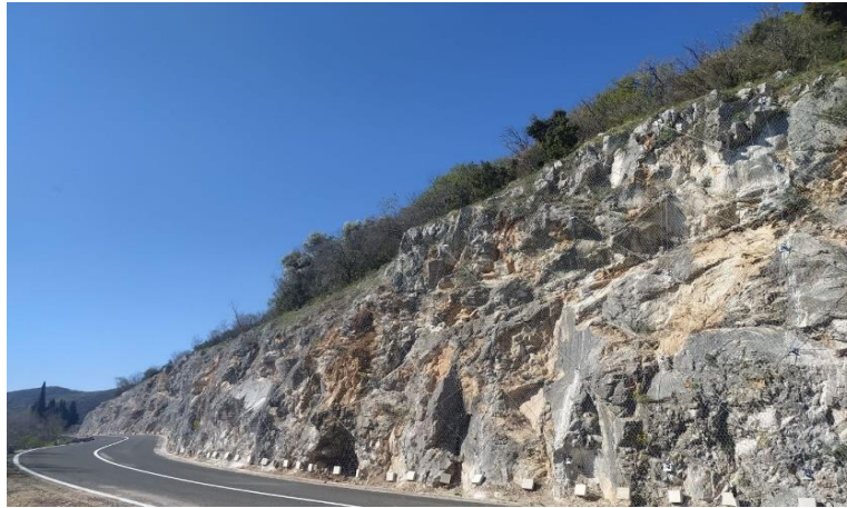
Slika 21. Sanacija padine ugradnjom zaštitne mreže ojačane čeličnom užadi te štapnih sidara (preuzeto s: https://www.geotech.hr/zastita-pokosa-na-dijelu-drzavne-ceste-d66-dionica-003-od-km-15000-do-km-23000/ )
