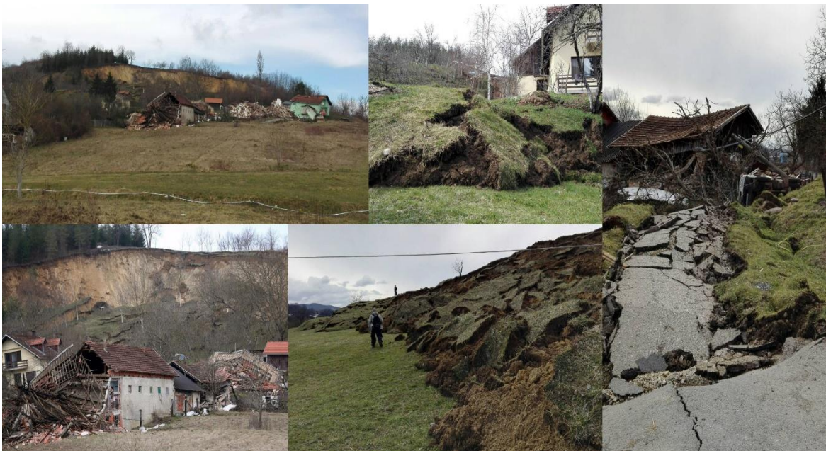
Slika 8. Klizište u Hrvatskoj Kostajnici 2018. godine [24]
