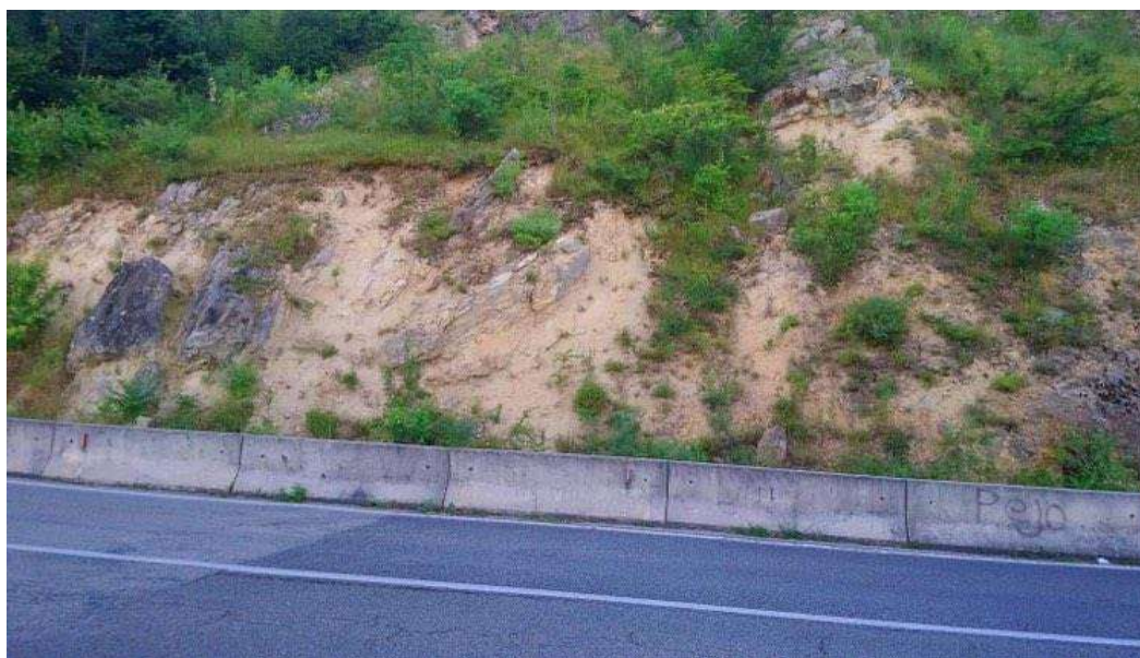
Slika 2 Primjer zaštitne ograde na državnoj cesti DC 1, dionica 16, Vrlika-Satrić
