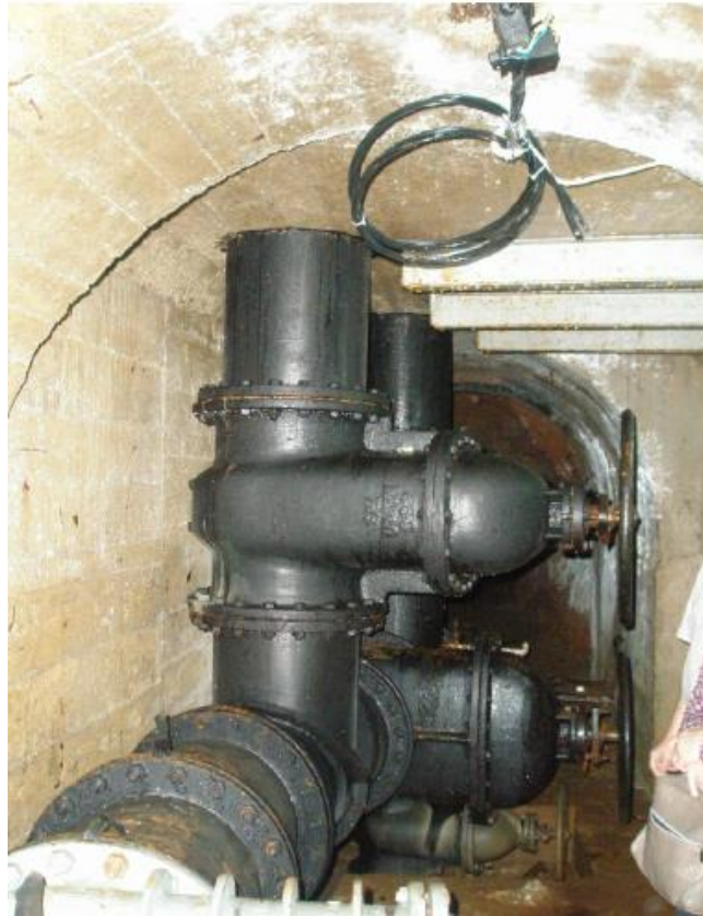
Slika 9. Ubodna cijev u hidrotehničkom tunelu [20]
